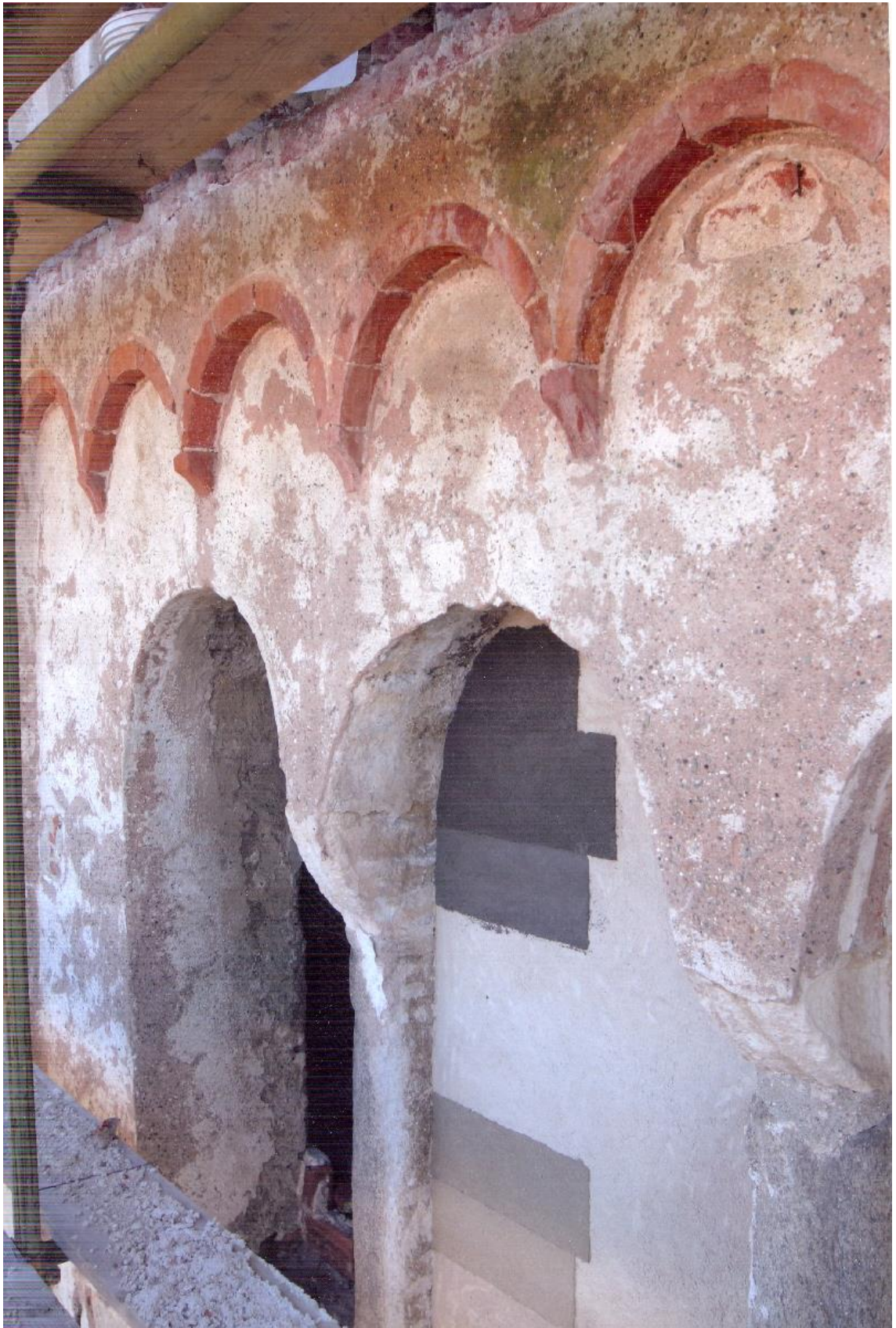
Sesto livello, lato est. Prove di colorazione del tamponamento dell'arco centrale della trifora, da valutare a distanza. È poi stata scelta una tonalità chiara, color coccio pesto, che denuncia il tamponamento senza tentare di nascondere.
